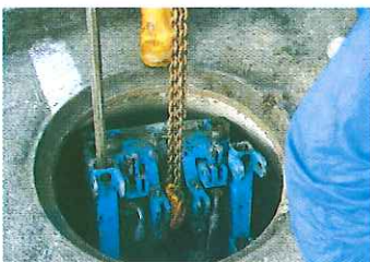
Éclatement à partir d'un regard
