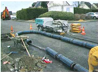
Présentation de tuyaux courts en PEHD
